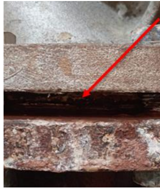
Gambar 5. Pengecekan kondisi packing pada flange .
